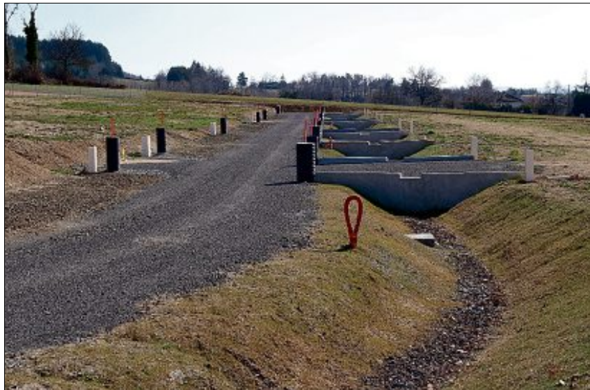
ENVIRONNEMENT. Le long des voiries, des noues ont été aménagées pour recueillir les eaux de ruissellement.
